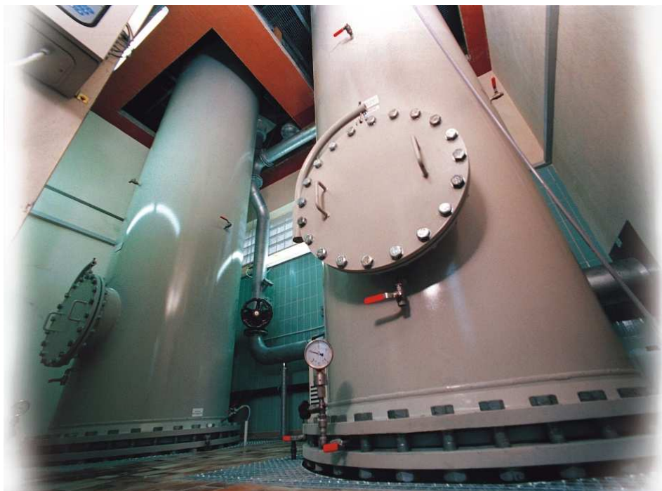
Bild 4: Enthärtungsreaktoren im Wasserwerk Bietenhausen
