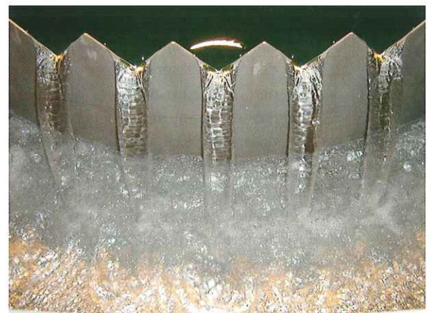
Bild 3. Der Klarwasserüberlauf im Reaktorauslauf.
