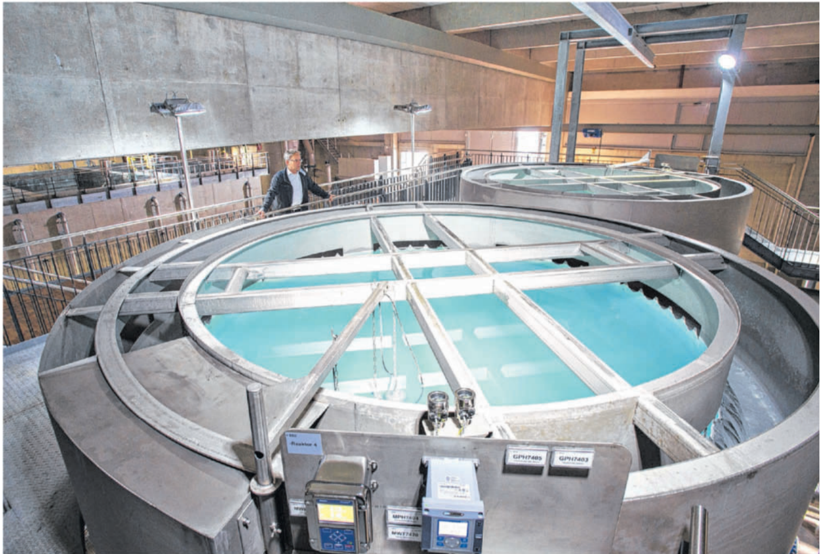
Sechs solcher zylinderförmiger Reaktoren gehören zur neue Schnell-Entcarbonisierungsanlage in Langenau.
